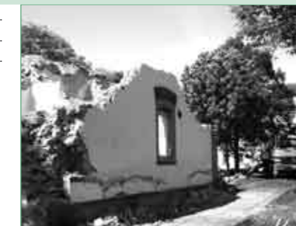
Gebäude 6 am Tennisplatz. Am 20. Mai standen noch einige Mauern,
